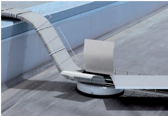
Üle tuletõkkeseina viidud bandaaziga kaablid
