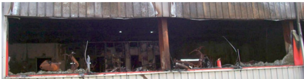
Korroosiivsete gaaside tõttu tekkinud tulekahjustused
