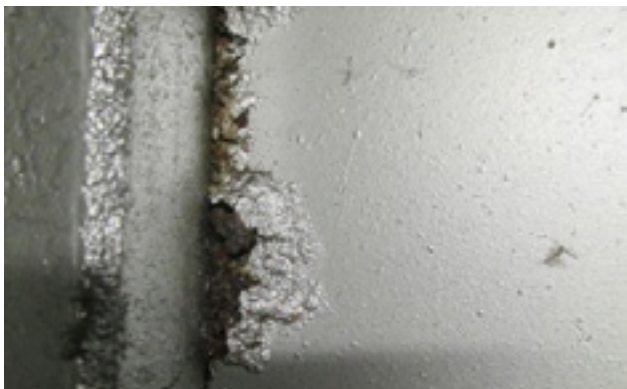
Korpuse pilukorrosioon. Kattekihti kahjustab selle all asetleidev progresseeruv roostetamine (Allikas: OBO Bettermann)
